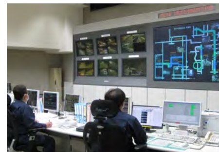
中央監視装置リニューアル
